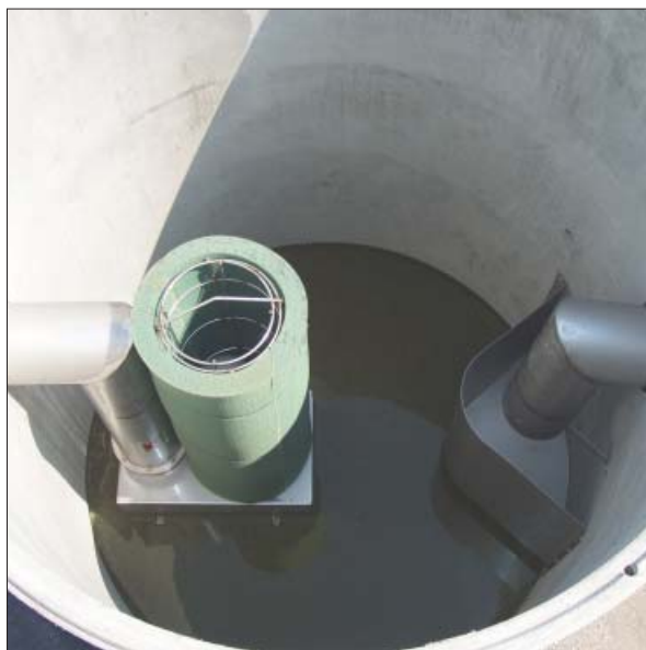
Olieudskiller indbygget i fiberbetonbeholder.
