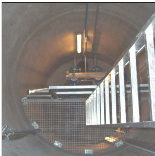
6,5 m dyb fiberbetonbeholder med pumpestation og mellemdæk.
